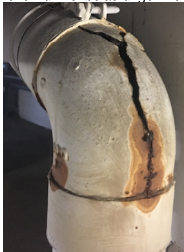
Bild 10: Korrosion in Verbindung mit Längsrissen
