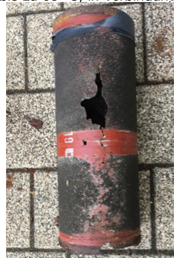
Bild 11: Korrosion in Verbindung mit Lochfraß/ Materialausbrüchen
